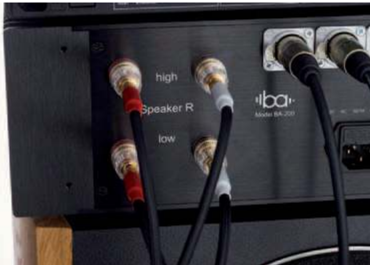
Anschlussstechnik Endstufe mit vier Ausgangsports für den digital-aktiven Betrieb der BB-10 Lautsprecher und symmetrische XLR-Eingänge
